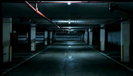
Spot lumineux défectueux (nexled.fr)
